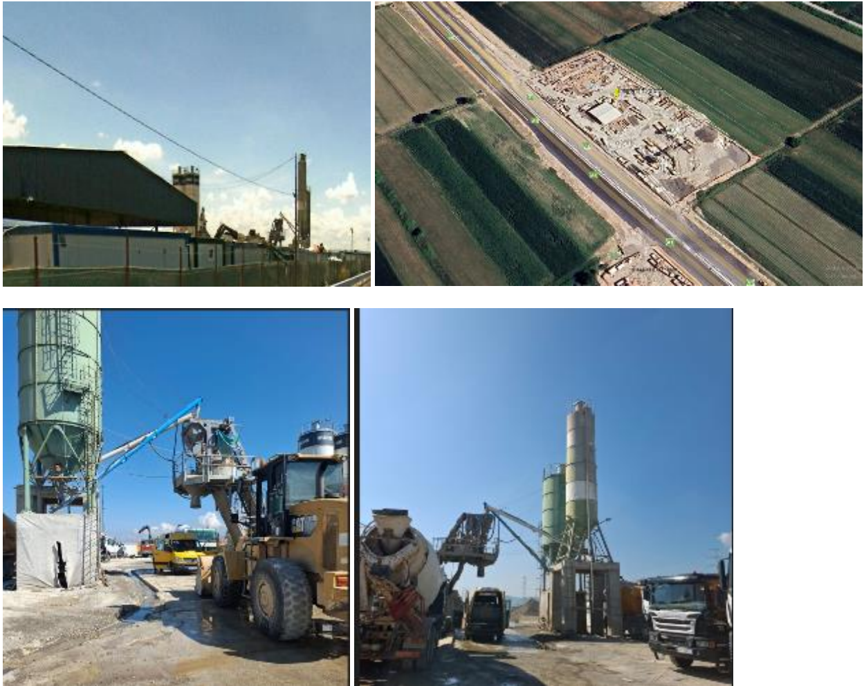
Figure 8: Pamje aktuale nga zona ku eshte i instaluar impianti
