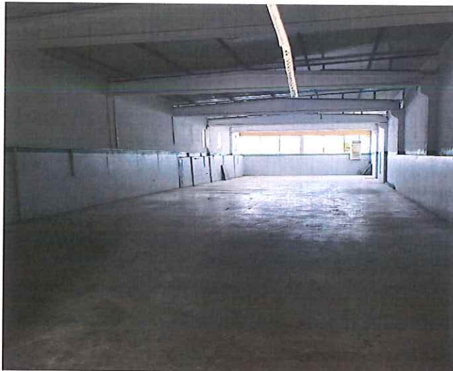
Fig.Ambjentet ku do te kryhet instalimi i depozitave plastike me strukture metalike
