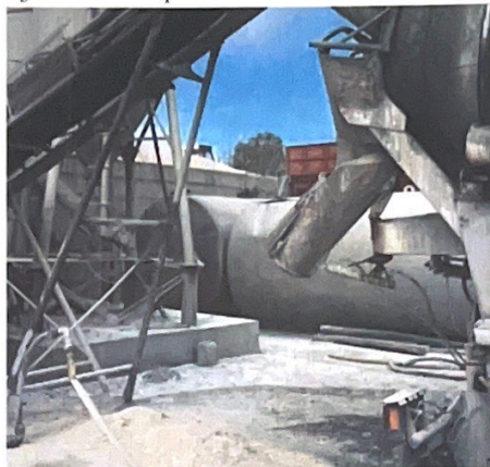
Foto 8 Depozitat e ujit
