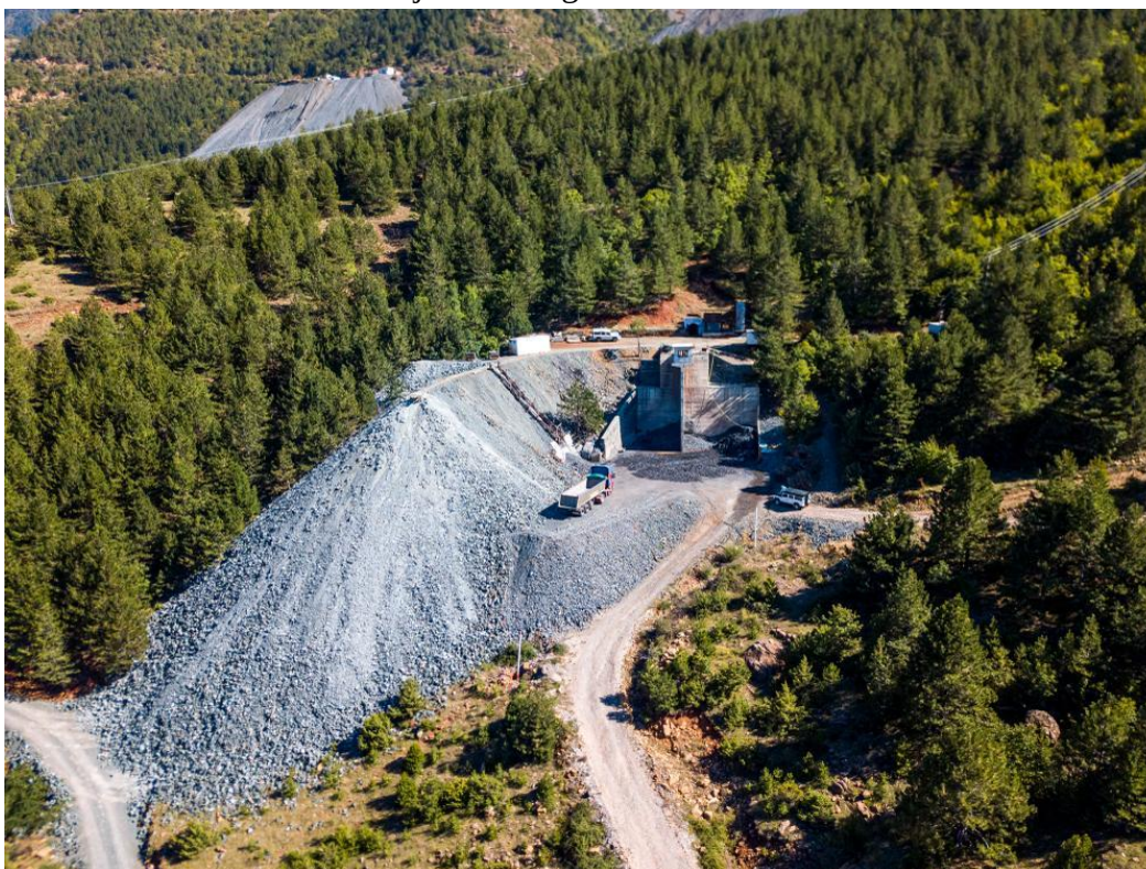
Pamje ballore e gjendjes aktuale te infrastruktures dhe hyrjes se galerise
