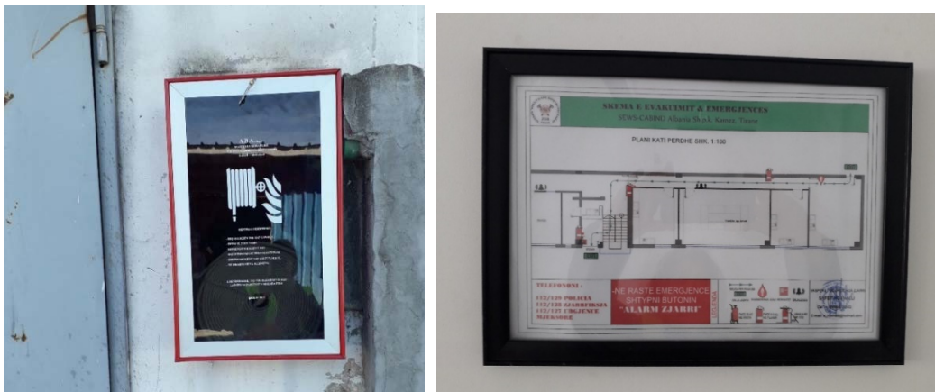
Figura 13: Elementë të sistemit të mbrojtjes ndaj zjarrit, të vendosur në instalim
