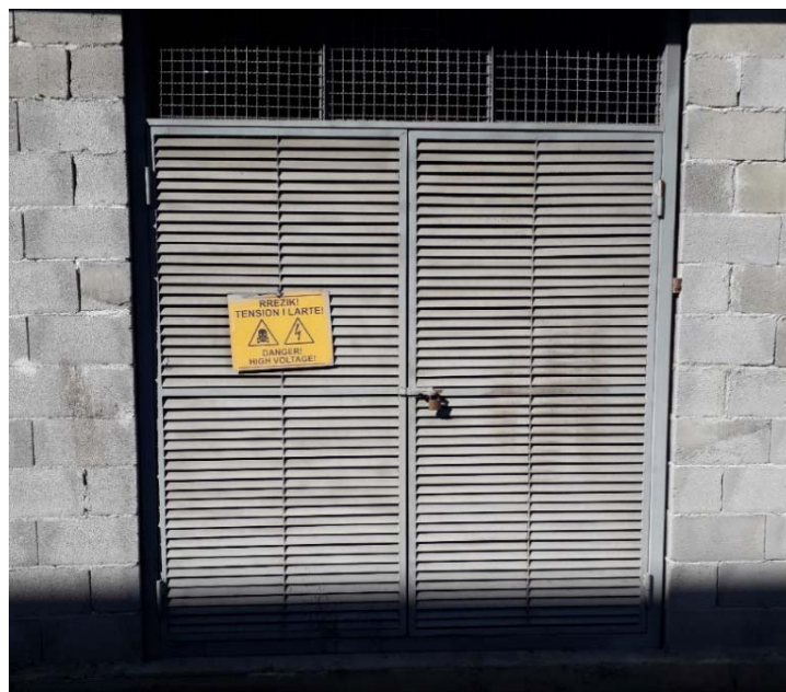
Figura 9: Kabina elektrike individuale e instalimit
