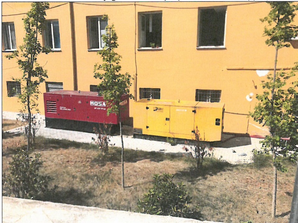
Pamje e Gjeneratoreve (vihen ne funksion automatikisht gjate nderprerjeve te rrymes elektrike. Lenda djegese Naftë e perpunuar Diesel 10 ppm)
