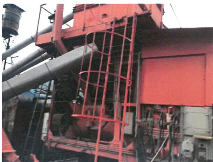
Foto te impiantit te prodhimit te asfaltobetone
