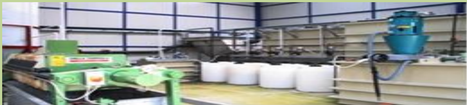
Fig.2. Impjantit depurator i pastrimit të mbetjeve
