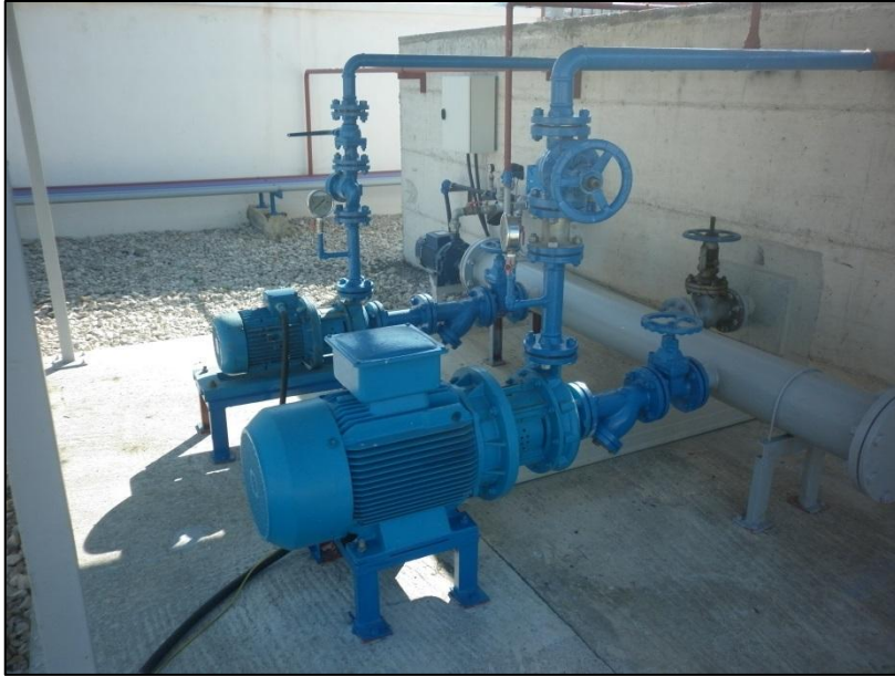
Fig.2.3 Foto nga stacioni i pompave dhe kompresoreve.
